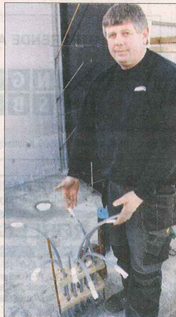
2 kilometer med kabler legges ned i de to gulvene i huset. Hallgeir Reitan bygger et system hvor temperaturen kan styres i alle rom.
